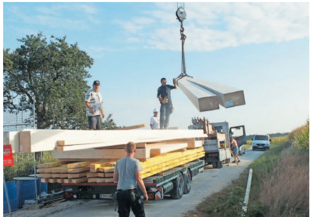
Für die Bedachung des neuen Vereinsheims der Krippenfreunde sorgt die Zimmerei Heiko Kurzmann aus Oberreichenbach.
